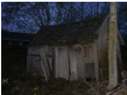
Bygget var hardt angrepet av råte Og bar preg av å ha stått uten tilsyn i lang tid.
